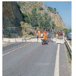
Strada statale 114. L'interruzione per la frana
